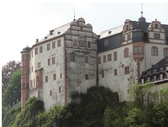
Algen an Fassaden
